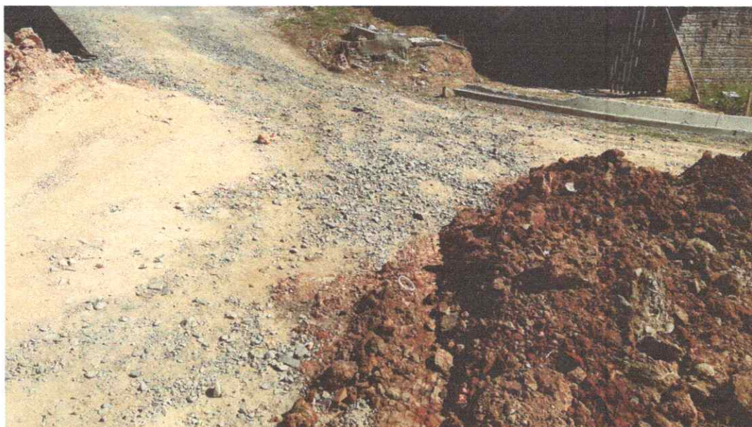
FOTO 01: TRECHO COM NECESSIDADE DE IMPLANTAÇÃO DE BOCAS DE LOBO E CAIXA DE LIGAÇÃO
